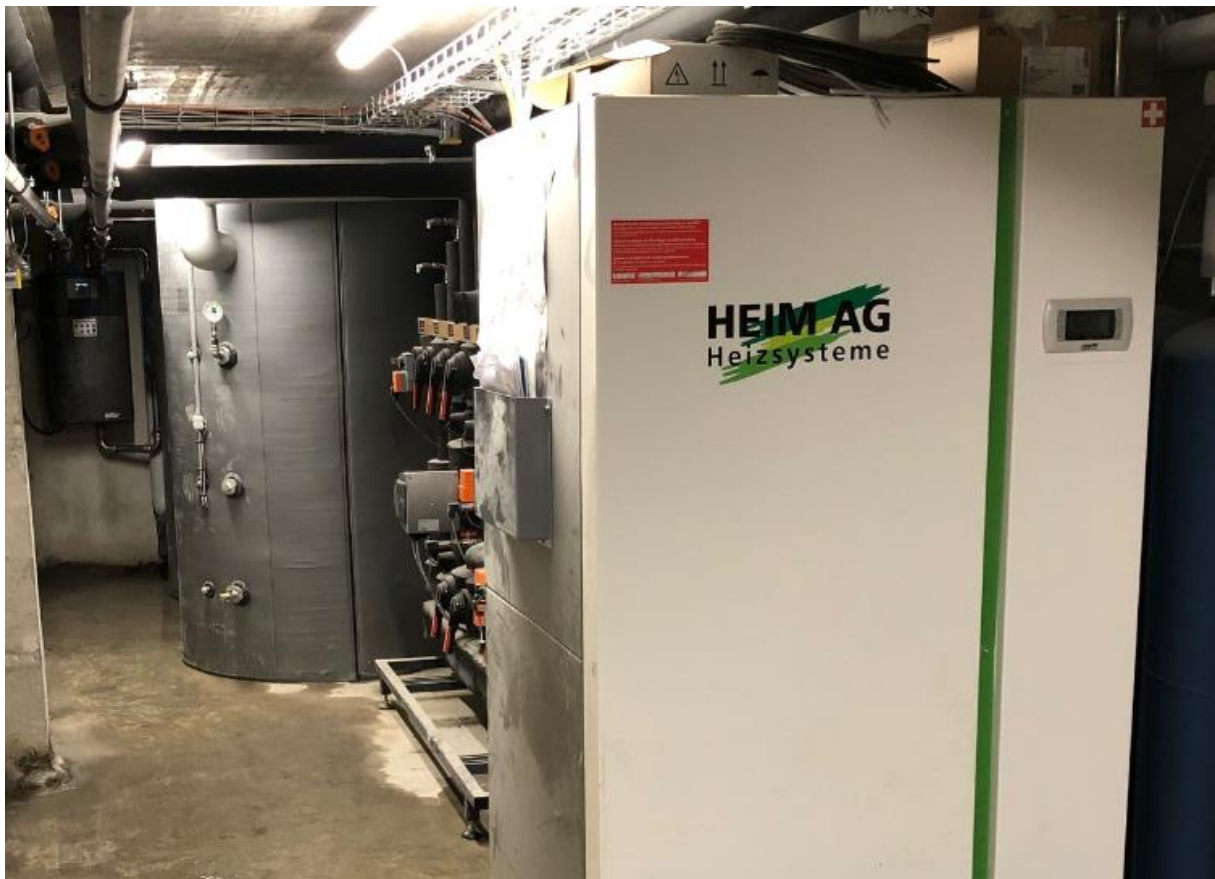
Wärmepumpe, Speicher, Frischwasserstation und vorgefertigtes Hydraulik-Modul
