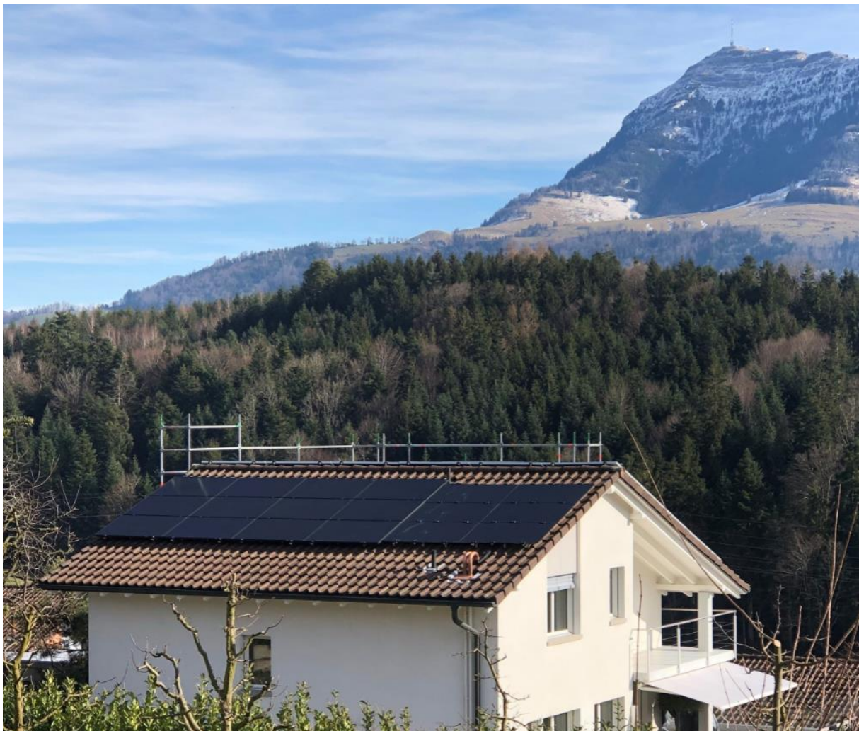
Nord-Westdach mit 6 PVT-Hybridkollektoren und 12 325W PV-Modulen
