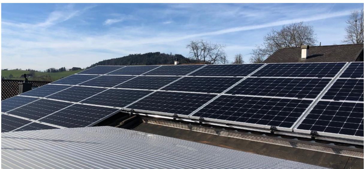
Süd-Ostdach mit 27 PV Modulen M315-60-w
